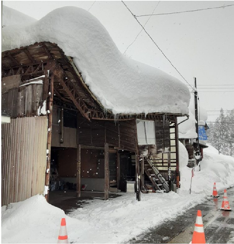
雪の重みで損傷した建物 (新潟県魚沼市)
