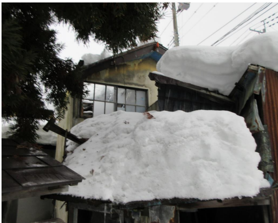
雪の重みで損壊した家屋（青森県弘前市）
