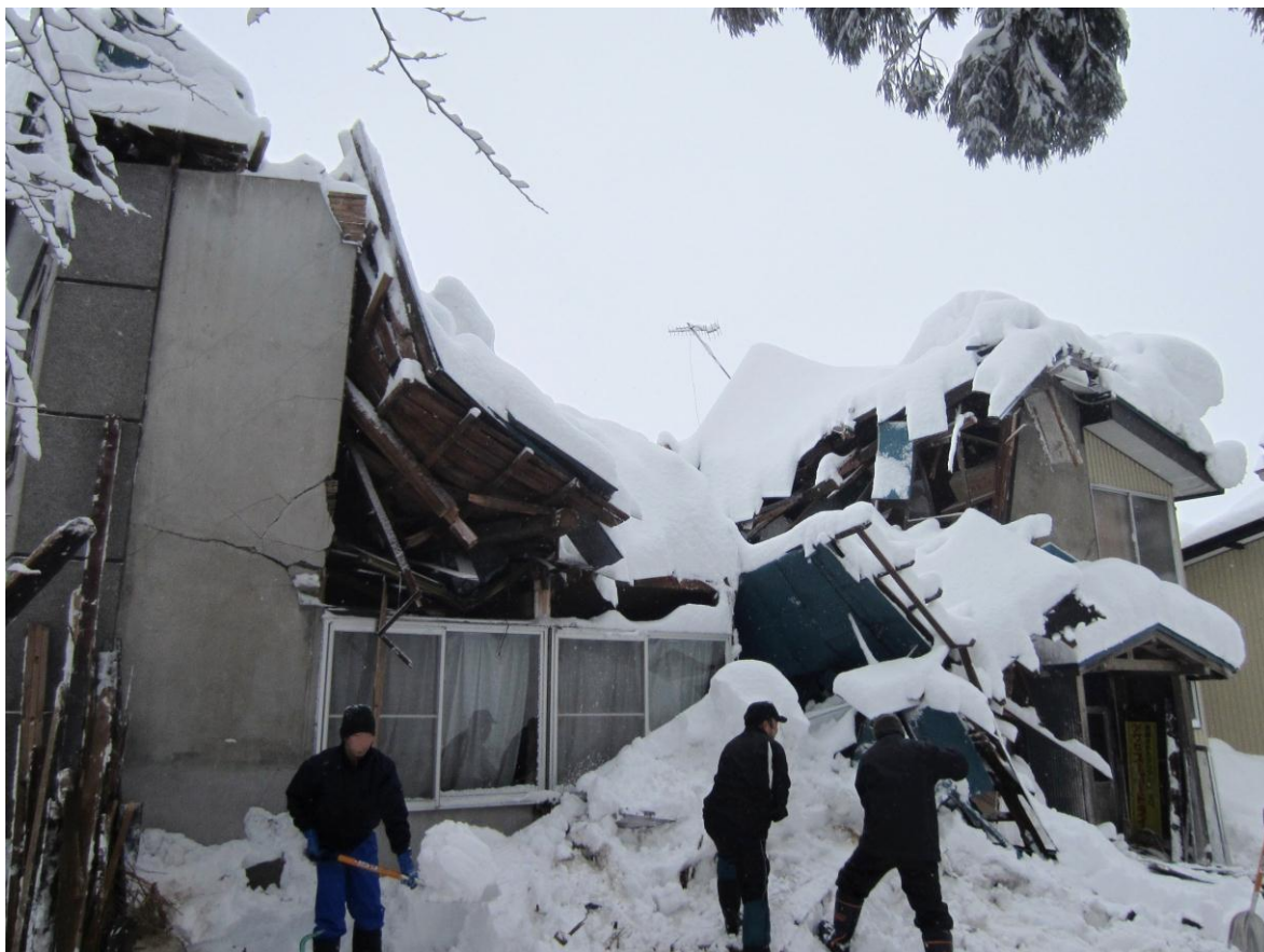
雪で倒壊した空き家（秋田県）
