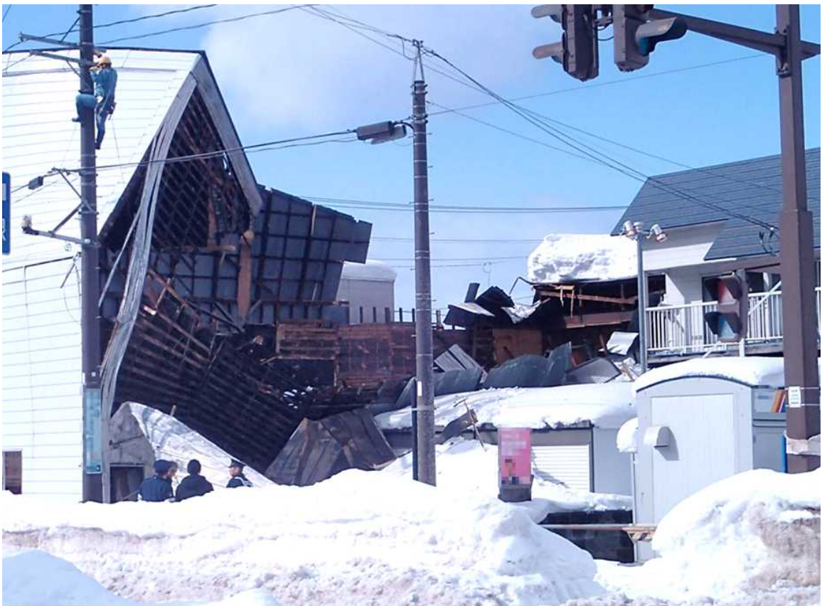
雪の重さで倒壊した建物（秋田県）
