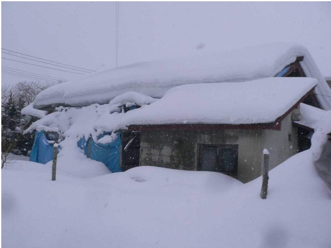
雪の重みでつぶれそうな空き家（青森県平川市）
