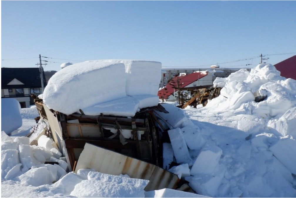
雪の重みで倒壊した空き家（北海道三笠市）
