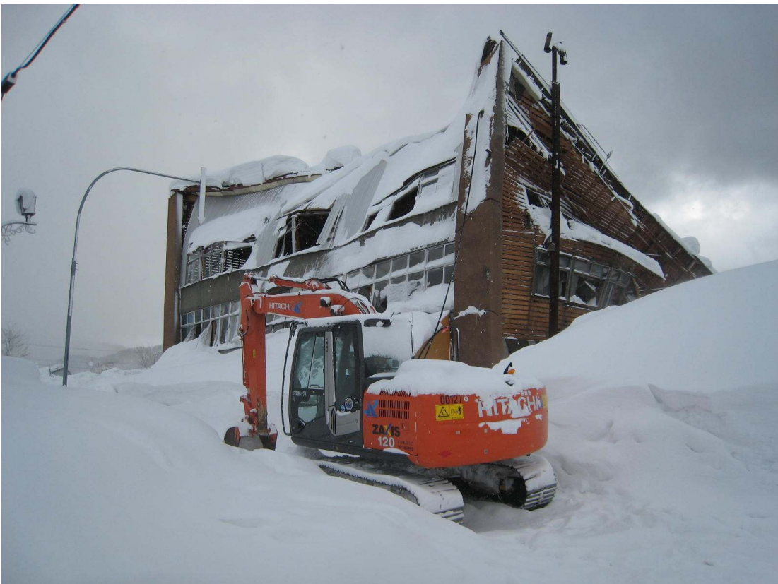
積雪により倒壊した建築物（北海道三笠市）
