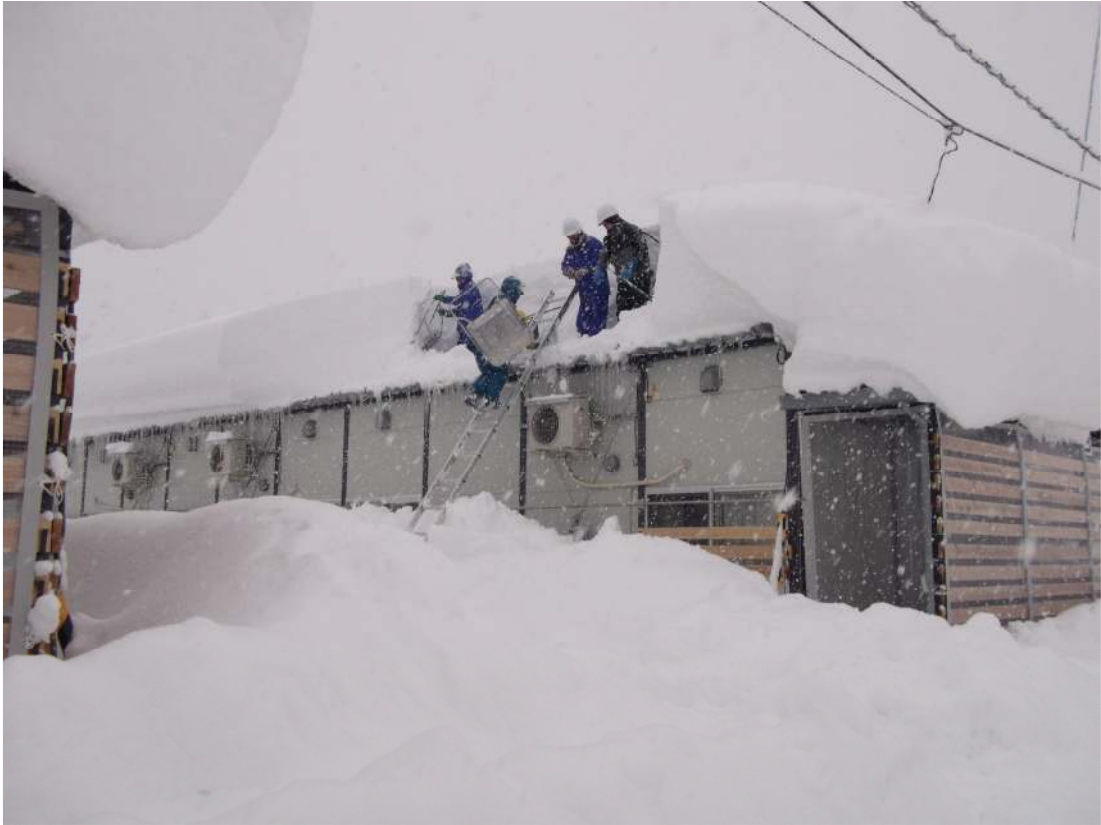
仮設住宅の屋根の雪下ろし（長野県栄村）
