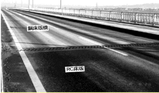
結露凍結（鋼床版橋VS鉄筋コンクリート床版） 2001年12月25日早朝 福井署管内で20件の事故、内11件が3鋼床版橋で
