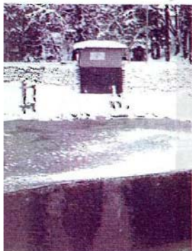
横手川から水を汲み上げるポンプ
