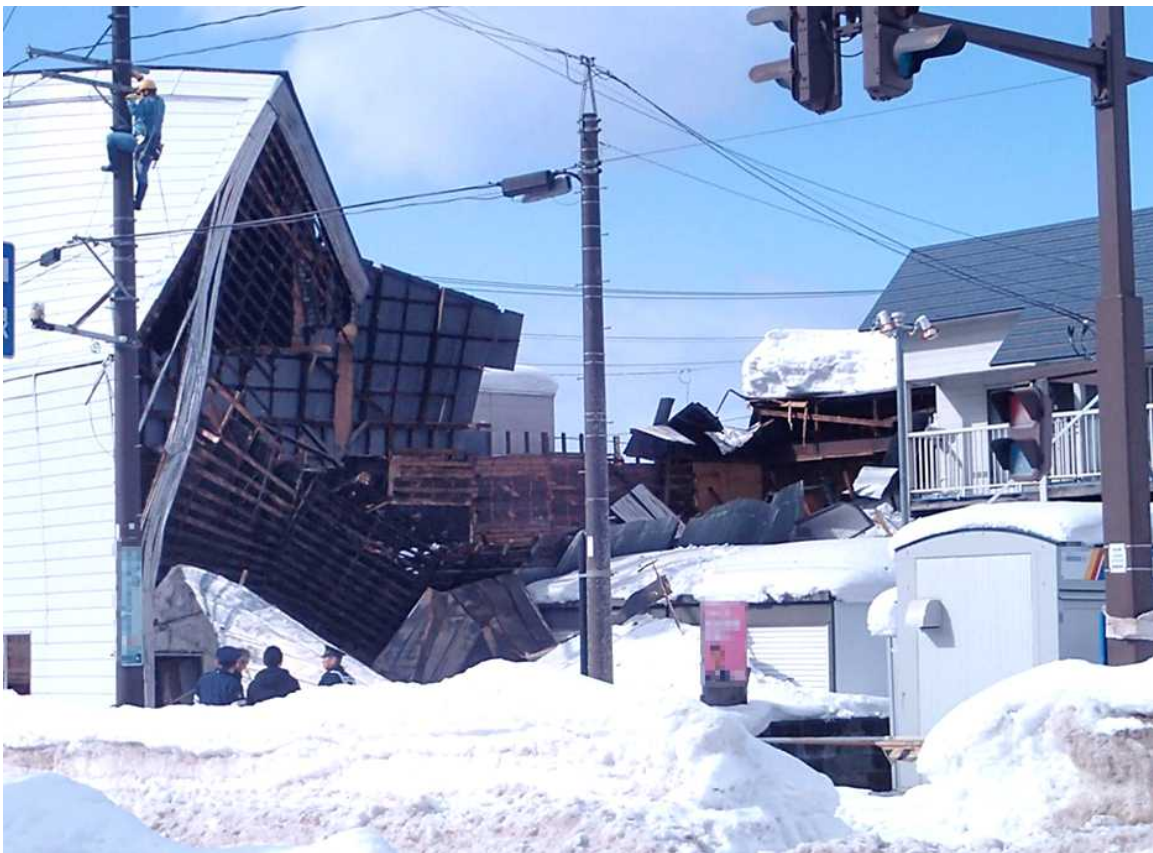
雪の重さで倒壊した建物（秋田県）
