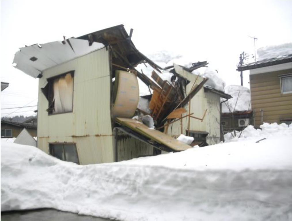
雪の重みで倒壊した家屋（新潟県魚沼市）
